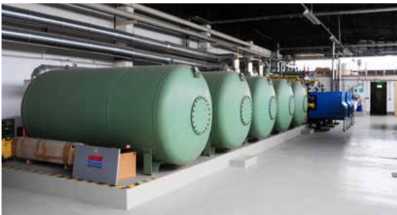
Aktuell verwenden die Pasewalker Stadtwerke im Heizhaus Öl und Gas.
